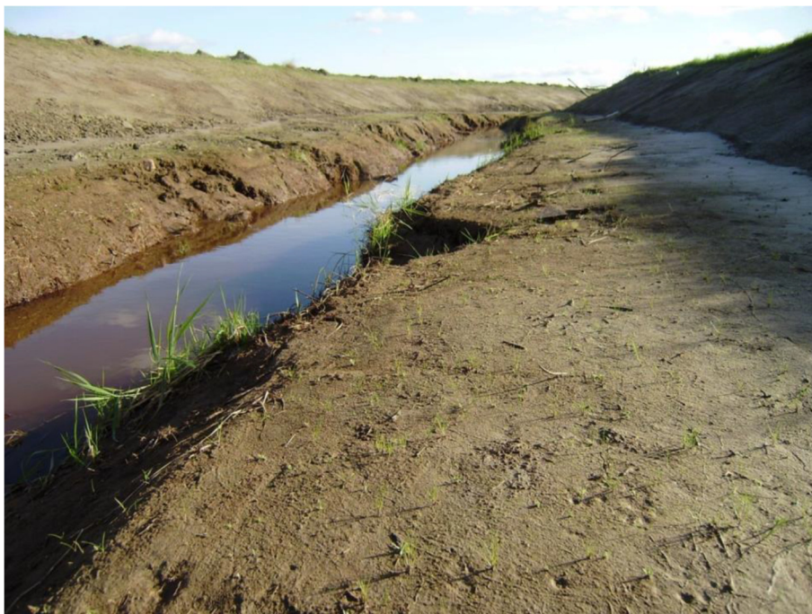
Kuva 8. Kuvassa tulvatasanne on kaivettu liian ylös. Ongelmana tuolloin on, että tulva vain poikkeustapauksissa ulottuu tulvatasanteelle. Kuva: Jukka Jormola
