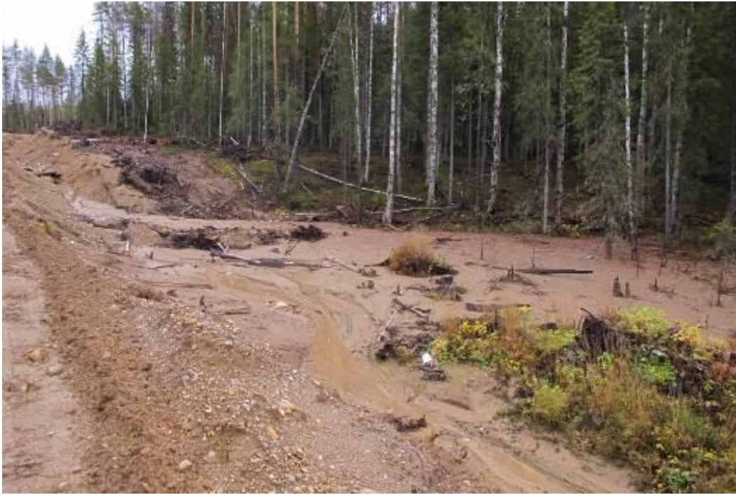
Kuva 31. Tie on syöpynyt voimakkaassa sadekuurossa.
