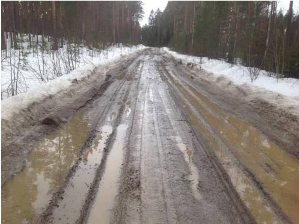
Kuva 9. Metsätien pintakelirikkoa. Aurusvallit ja reunapalteet estävät sulamisveden poistumisen tien pinnalta, mikä pahentaa pintakelirikkoa.
