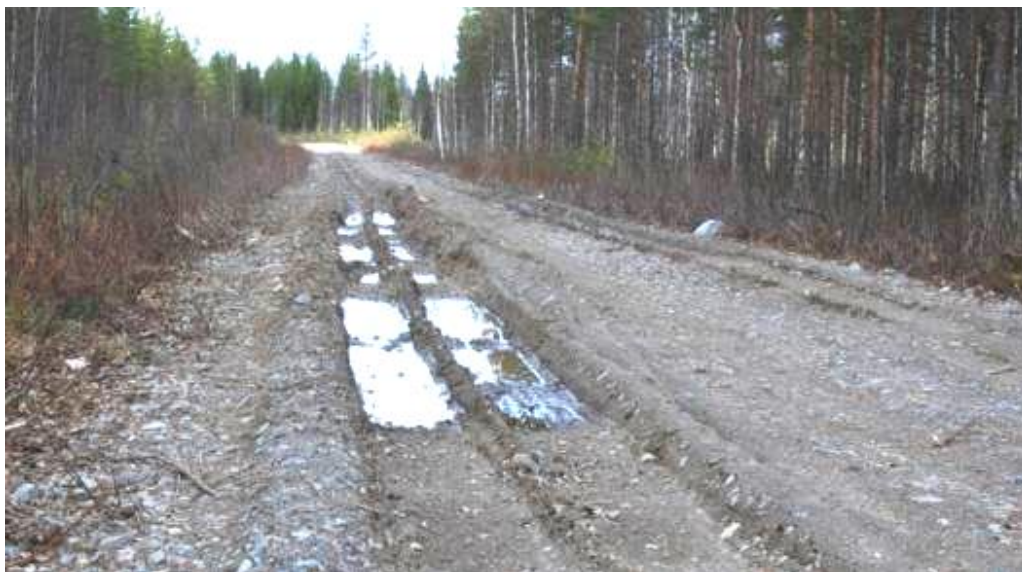
Kuva 12. Vesi ja raskas liikenne ovat yhdessä pahimmat metsätien vaurioiden aiheuttajat.
