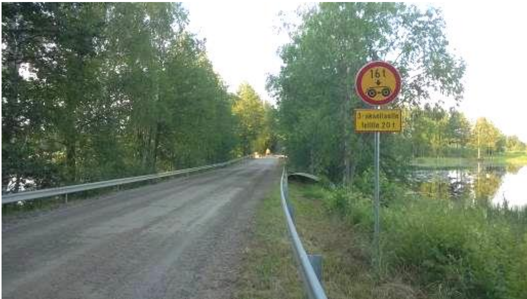
Kuva 37. Uusien 68 tonnin ja 76 tonnin puutavara-autojen kolmiakseliset telit rasittavat huonokuntoisia siltoja.
