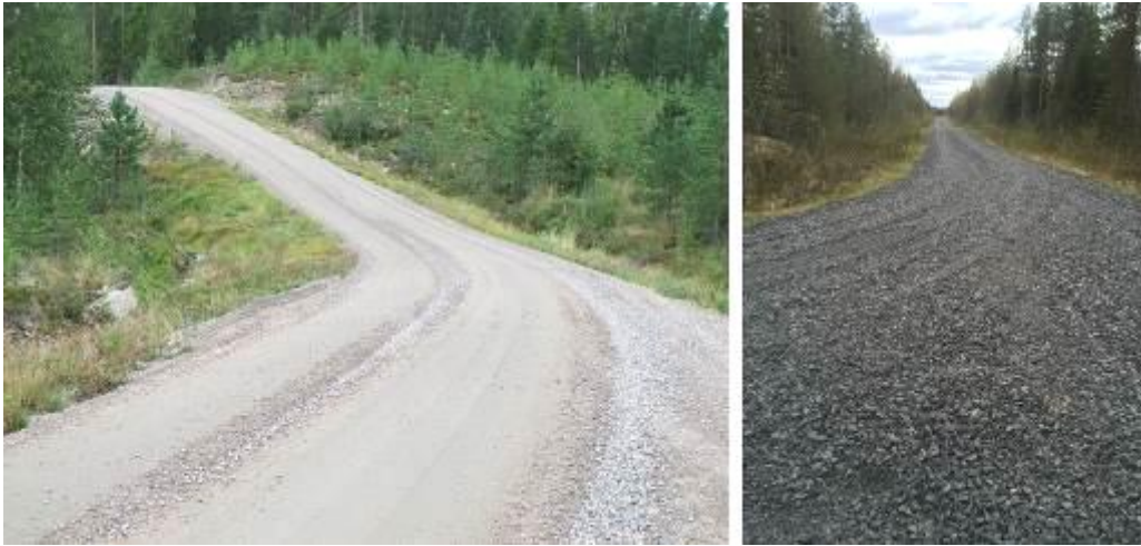
Kuva 21. Vasemmassa kuvassa on käytetty hyvää materiaalia kulutuskerrokseen. Oikeanpuoleisella tiellä murske ei sitoudu, koska siinä ei ole tarpeeksi hienoaainesta.
