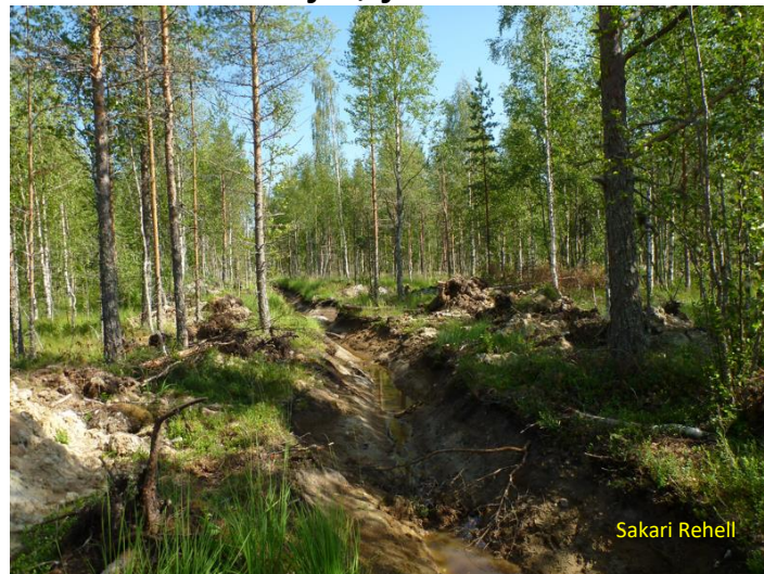
Vasta perattu syvä, pohjamaahan ulottuva metsäoja vie valuma-alueen vettä suon ohi. Pyhäntä, Tattarinevan reuna.
